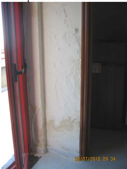
Foto 41 Tinello con fenomeni di infiltrazioni di acque meteoriche lungo la parete perpendicolare al vano porta che immette sul terrazzo a livello
