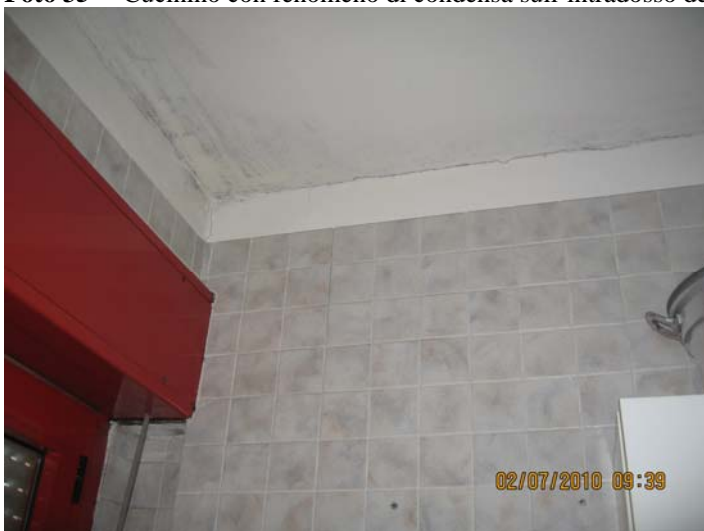
Foto 35 Cucinino con fenomeno di condensa sull'intradosso del solaio
