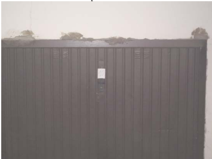
Foto 17 Serranda tipo basculante del primo box ad incominciare da sinistra, situato di fronte per chi scende attraverso la rampa carrabile di Via Milano
