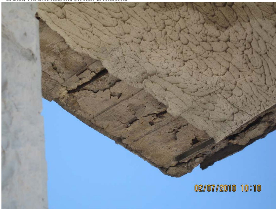
Foto 54 Stato decadente dell'intradosso del cornicione di coronamento su Via Magenta, angolo Via Bari, con la fuoriuscita dei ferri di armatura.
